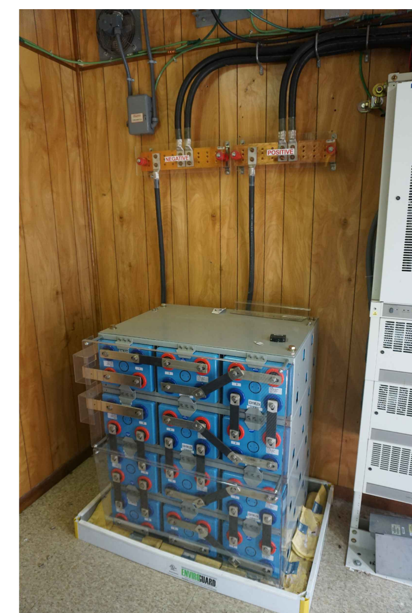
INTERIOR VIEW: BATTERIES SCALE: N.T.S.
