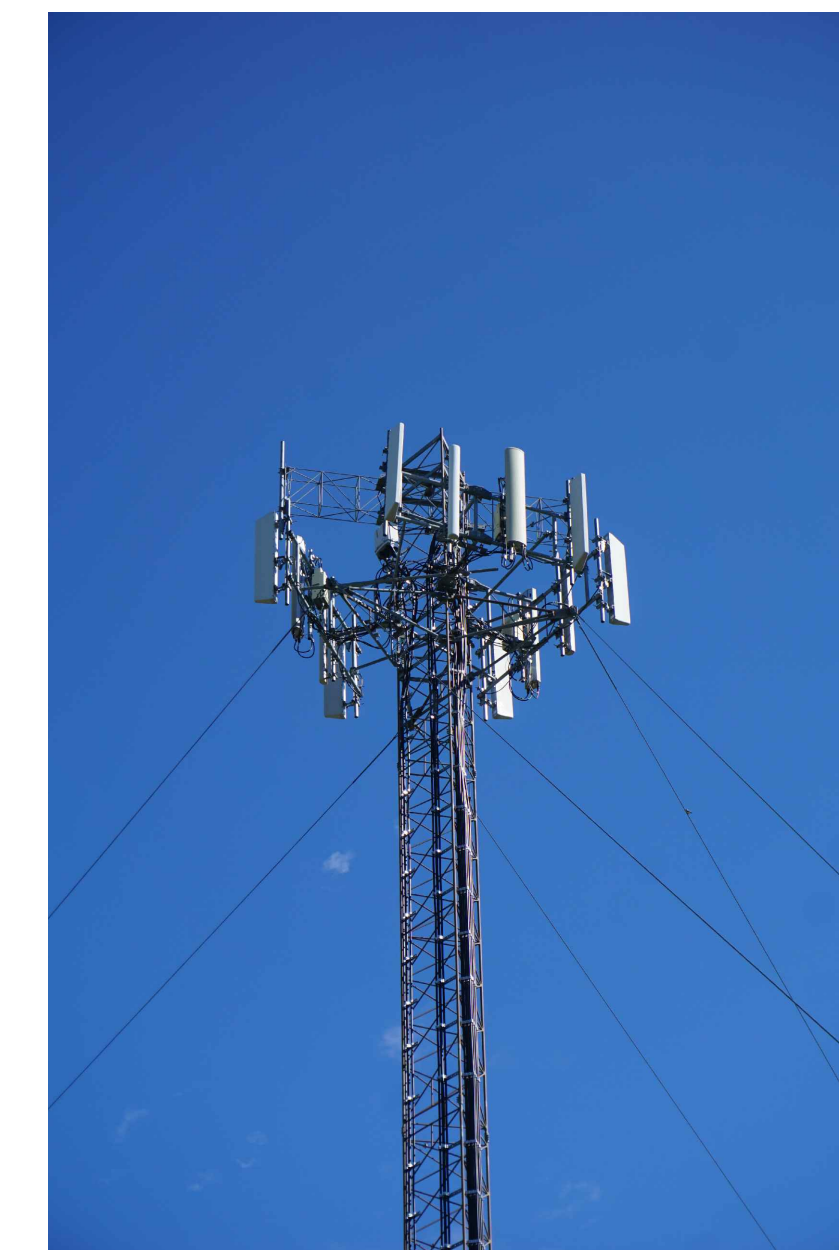
3 EXTERIOR VIEW: ANTENNAS SCALE: N.T.S.
