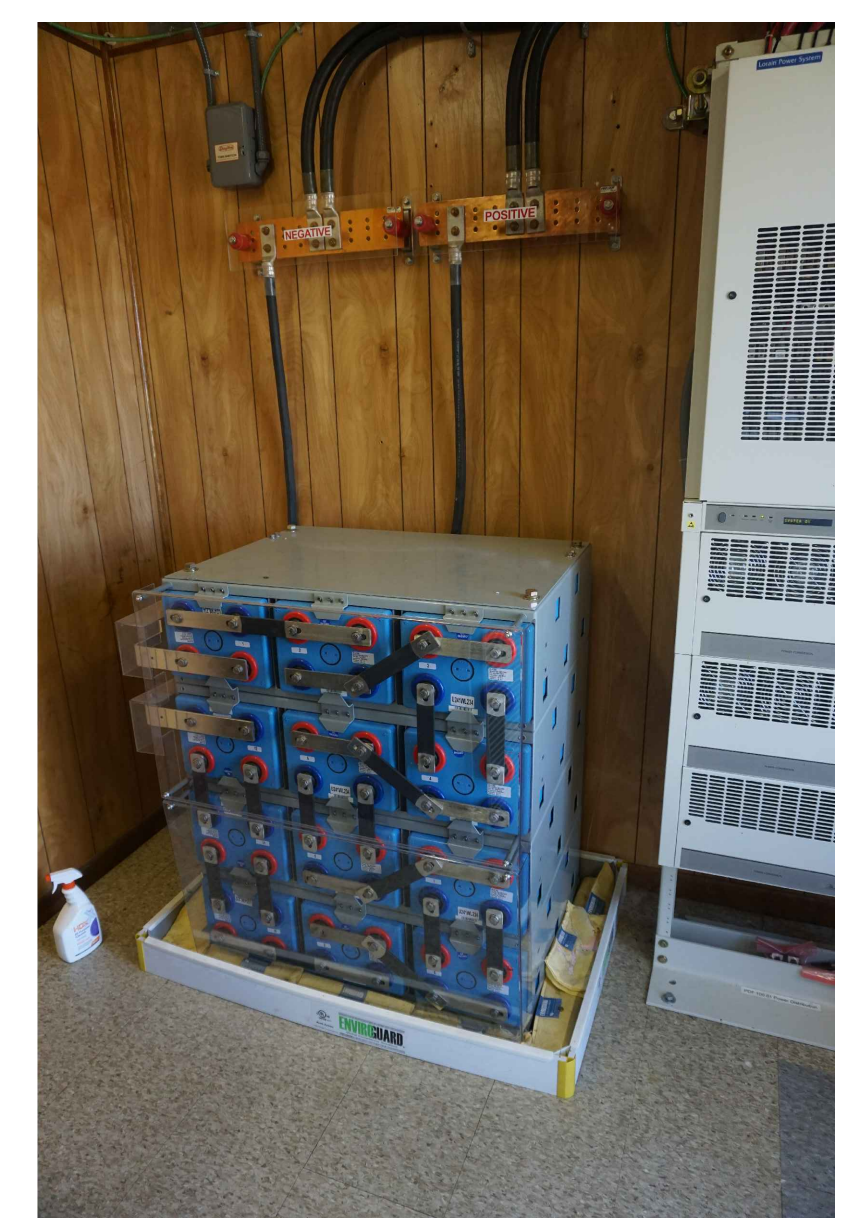
INTERIOR VIEW: BATTERIES SCALE: N.T.S.
