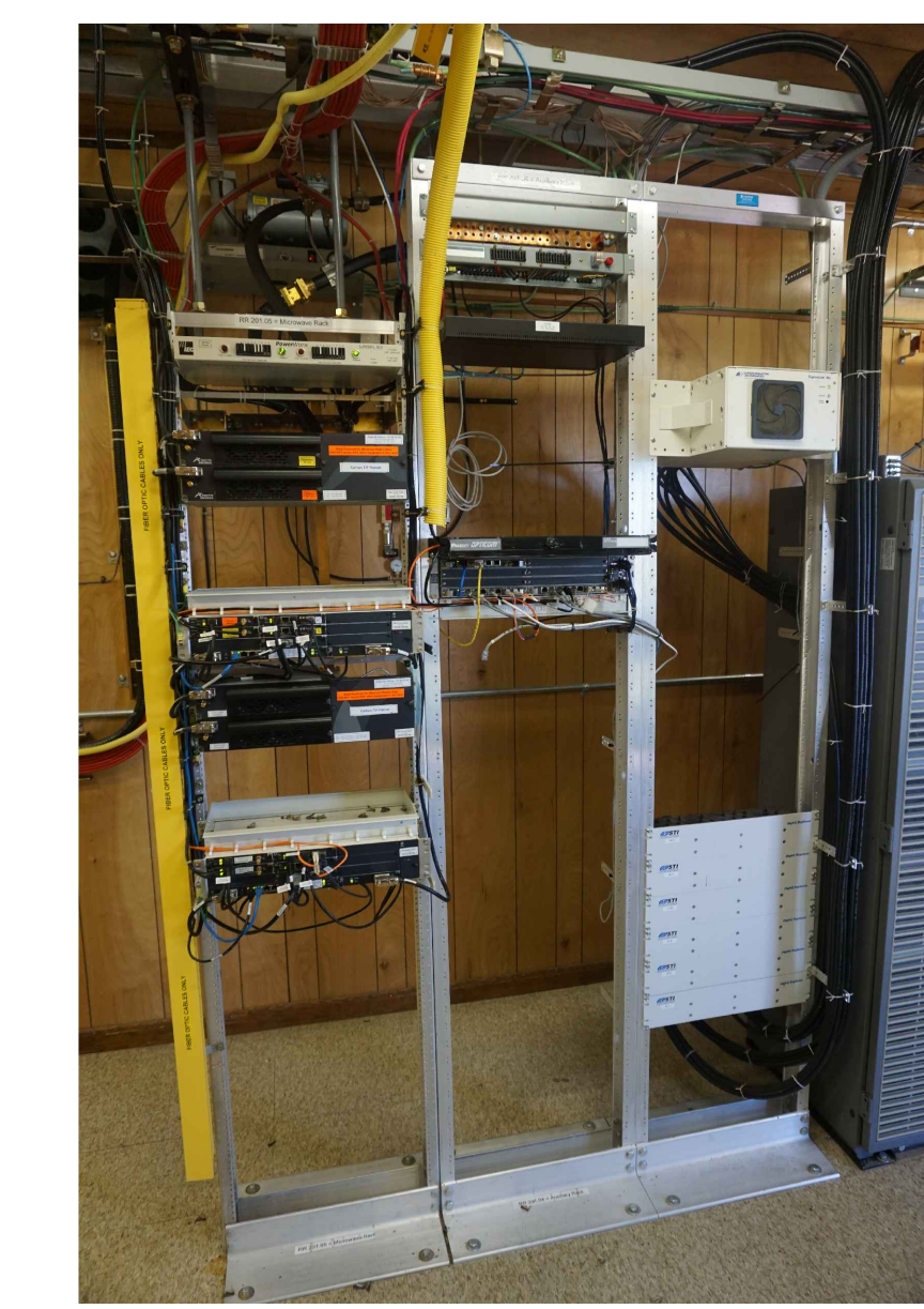
INTERIOR VIEW: MW & FIBER RACKS SCALE: N.T.S.
